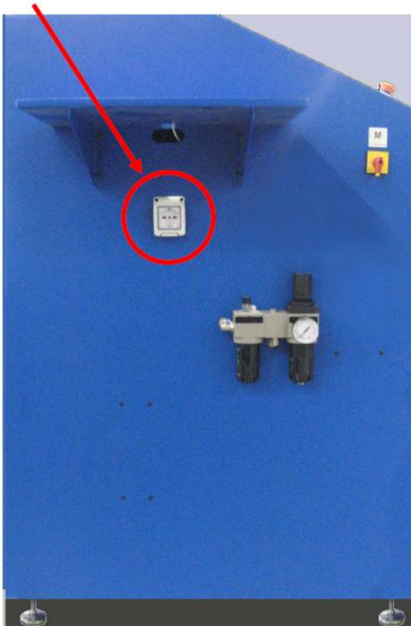
Рис. 10.В Электрическая розетка 220В для принтера
